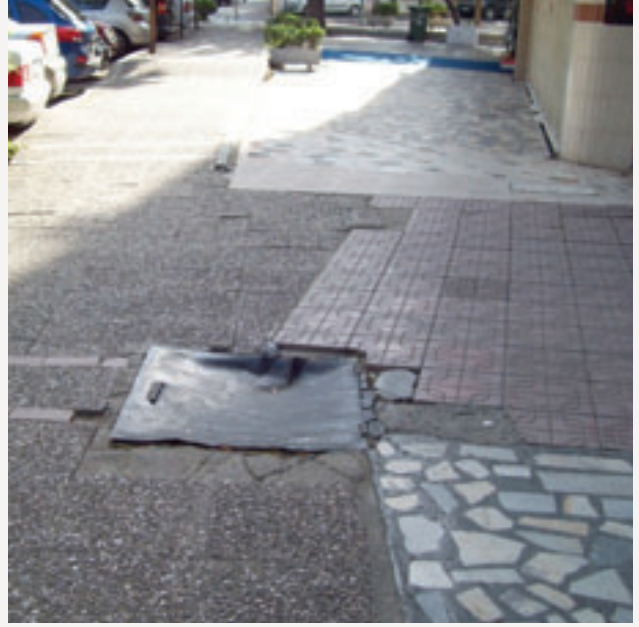
Kaldırım ve bina önü yer döşemesi karmaşası.
