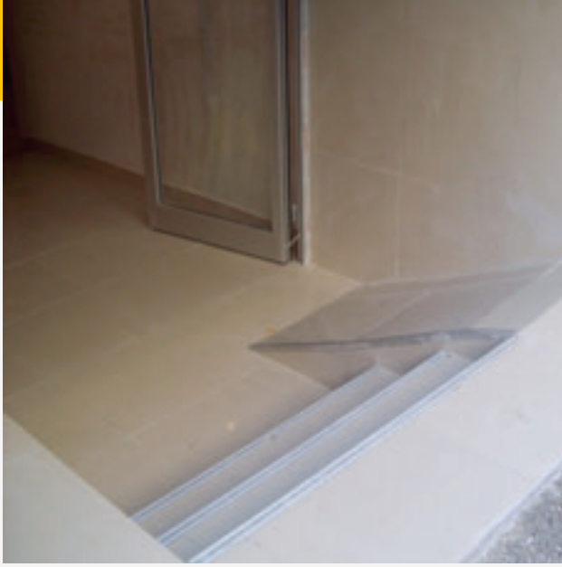
Apartman girişı – Rampa uygulaması- dik, dar, korkuluksuz, kaygan yüzeyli
